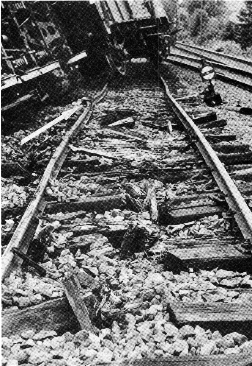
Bild 29 Oberbauzerstörung durch Entgleisung
