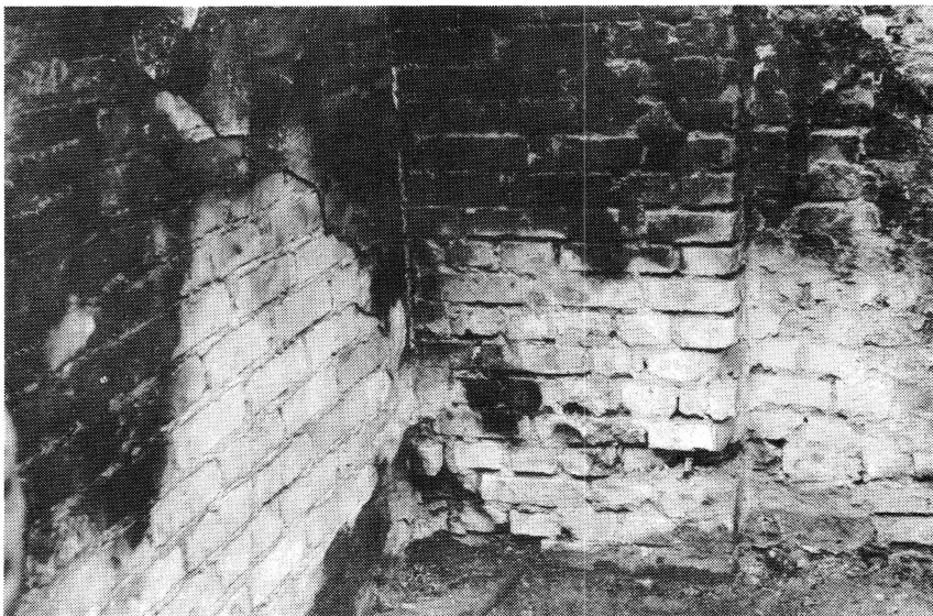
Bild 21 Hitzeeinwirkung an einer Mauer
