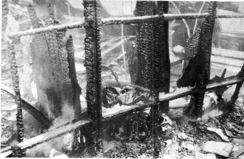
Bild 20 Brandspuren an einer Holzwand
