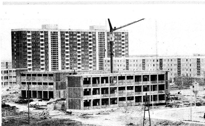
So sah der Schulbau im Wohnkomplex I von Rostock-Lütten Klein noch vor wenigen Monaten aus.
