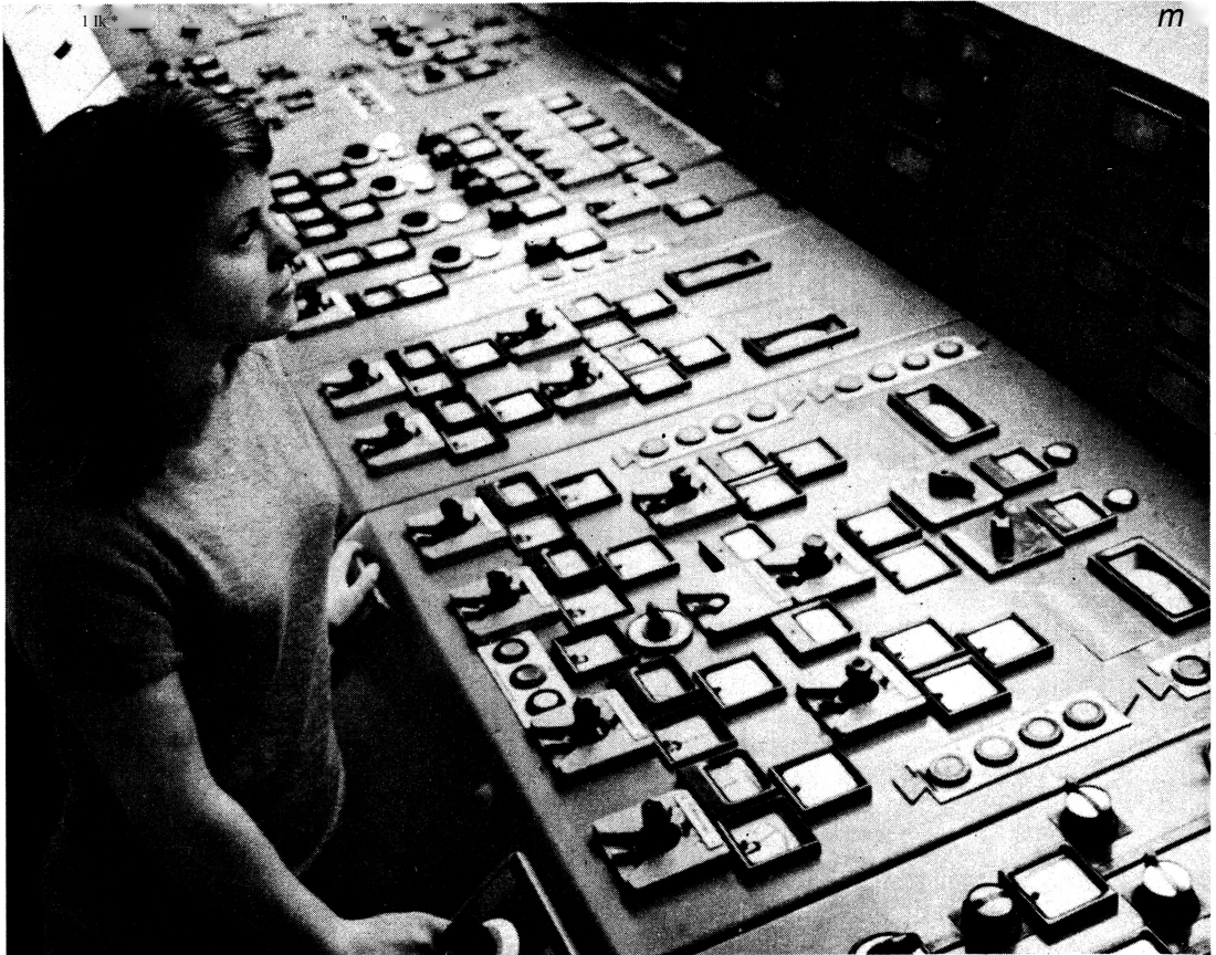
Meßwarte im Betriebsteil 3 des Spreewaldkraftwerkes Lübbenau. Die verantwortungsvolle Arbeit von Renate Klauke entscheidet mit darüber, ob der ihr anvertraute 100-MW-Block seine maximale Leistung bringt.
