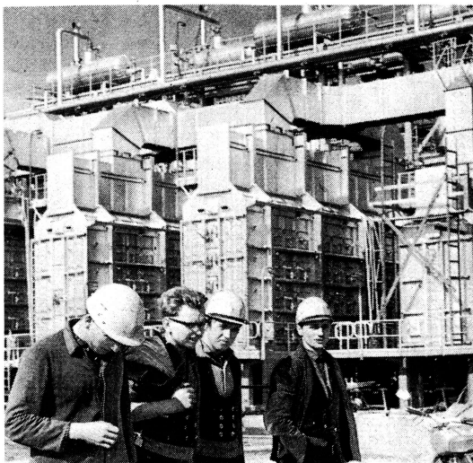
Die zweite Aufbaustufe des petrochemischen Zentrums Leuna II wächst. Hier ein Blick auf die Benzinspalanlage.
