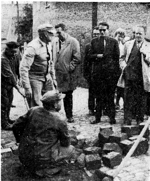
Genosse Otto Gotsche, Sekretär des Staatsrates der DDR, begrüßt Mitglieder der Rentnerbrigade in Holdenstedt, Kreis Sangerhausen, die große Verdienste beim Bau der Wasserleitung des Ortes haben
